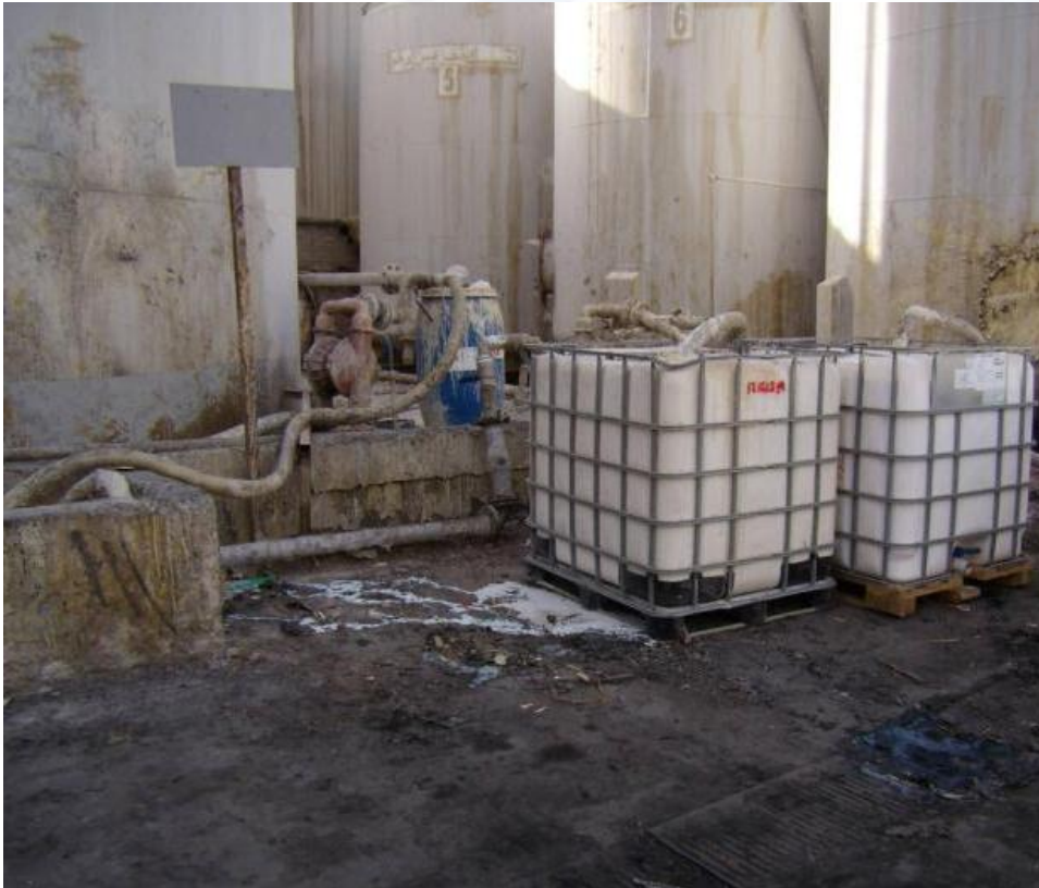
Chemikalien-Mischstation einer Teppichfabrik in Ägypten
